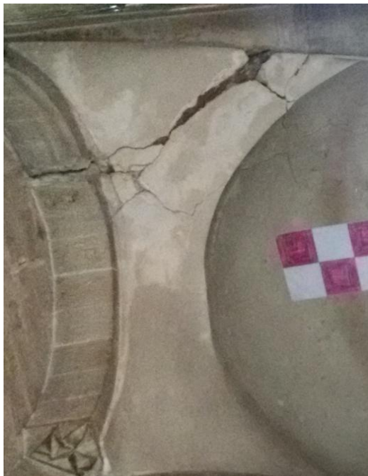
شكل ١٣. شروخ واسعة ونافذة في منطقة انتقال إحدى القباب. (تصوير الباحثين).
