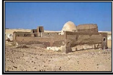
صورة (١) توضح تأثير نحر الرياح وتراكم أعشاش النحل البري
