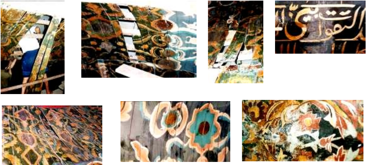
شكل رقم ٧ يوضح خروج الأخشاب عن مكانها الطبيعي في القبة وظهور مسامير التثبيت والزخرفة الخاطئة نتيجة الترميم والتركيب السابق
