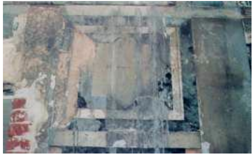
ج- الترميم الخاطئ باستخدام الطوب الأحمر والجبس
