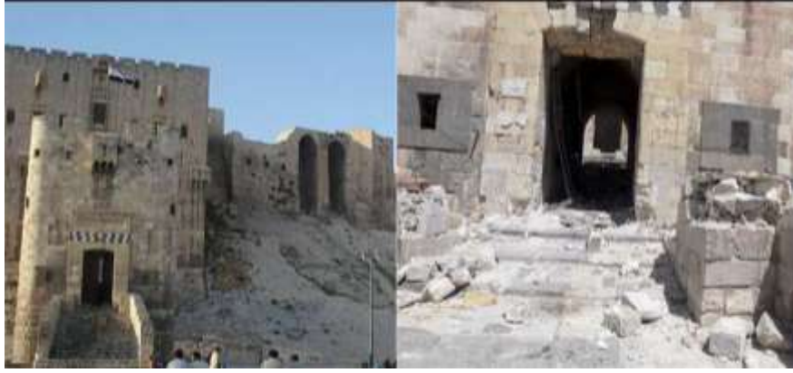
(شكل ١٨) صورة توضح تدهم البوابة الرئيسية بقلعة حلب جراء الزلزال
