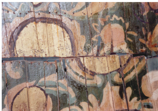
شكل رقم (٦) التركيبات الخاطئة في أجزاء الخشاب وحدوث انكماش في الأخشاب أثر بالسلب على الفواصل بين الألواح
