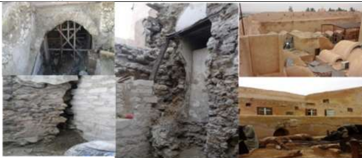
(لوحة ٨) توضح حدوث تساقط وانهدارات لبعض مواد البناء علاوة على وجود الشروخ العميقة وانفصالات بالدرن © تصوير الباحثين
