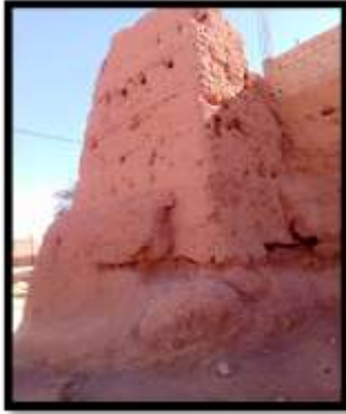
(لوحة ١) تشقق و تصدع المباني بفعل الحرارة © عمل الباحث
